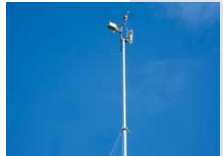
Mastkopf mit Wetterstation & Abspanneinheit
