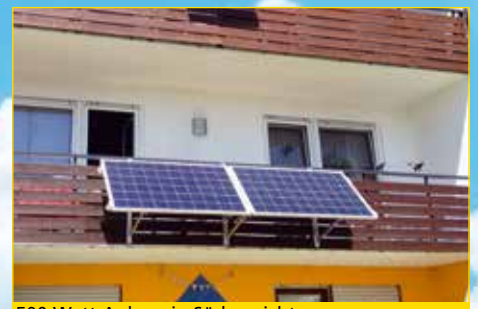
500 Watt Anlage in Südausrichtung
