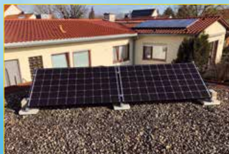
Südausrichtung bei einem Modul auf Flachdach
