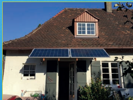
Glas-Glas Module als Vordach
