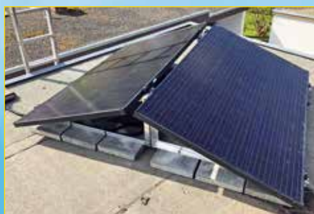
Ost-West Ausrichtung mit zwei Modulen auf Flachdach.
