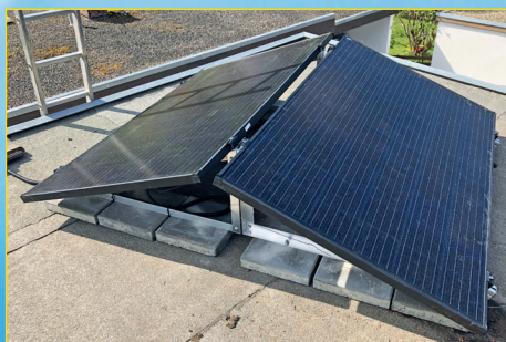
Ost-West Ausrichtung mit zwei Modulen auf Flachdach.
