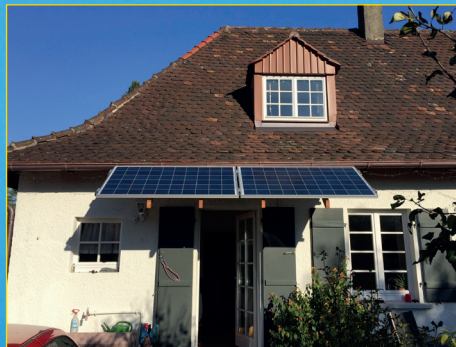
Glas-Glas Module als Vordach
